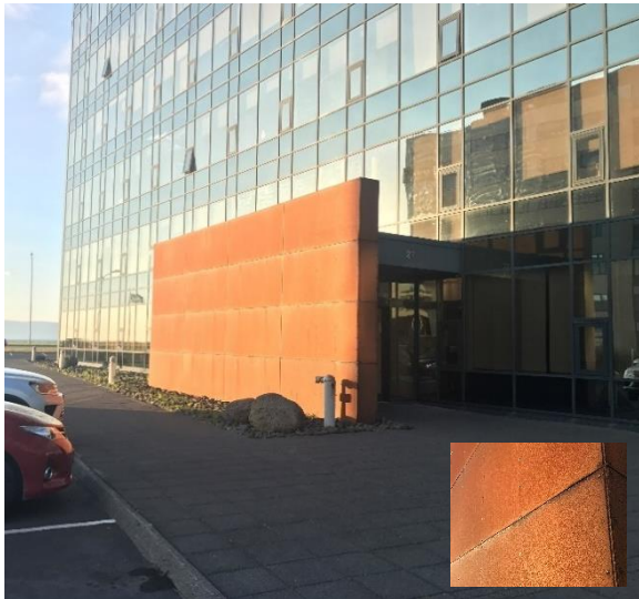
MYND 21 Veggur klæddur kortenstáli við Borgartún 27. Húsið er ekki í meira en 100 metra fjarlægð frá sjó (Efla, 2017).
