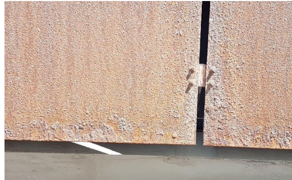
MYND 24 Tæring klæðningarinnar er ójöfn (Efla, 2017).
